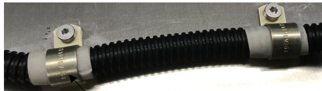
P-クランプ P-クランプによる配線固定
